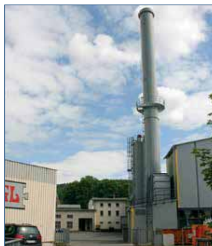
Die neue Absauganlage verhindert Staub- und Geruchsbelästigung.
